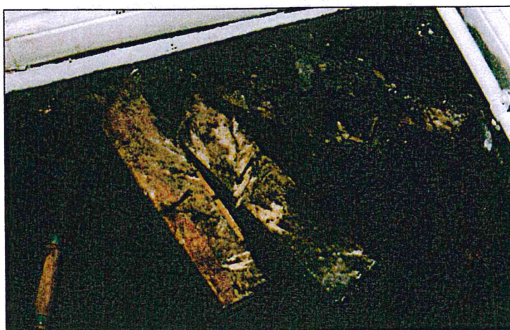
Das Parkett – von oben ohne erkennbare Schäden, jedoch mit kräftigem Myzel des Echten Hauschwamms unter dem Parkett
